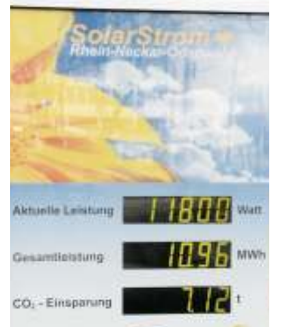
Eine Anzeigentafel am Eingang des HSC weist auf die Leistung der Fotovoltaikanlage auf dem Dach hin.
